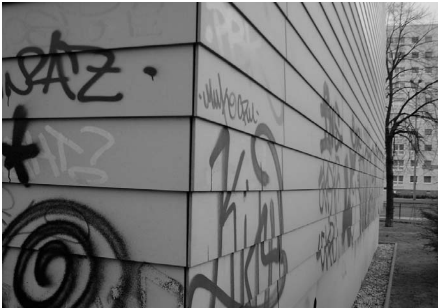
Figura 9. Berlín. Fachada de un edificio de viviendas ya rehabilitada, que ya ha sido invadida por los graffiti .
